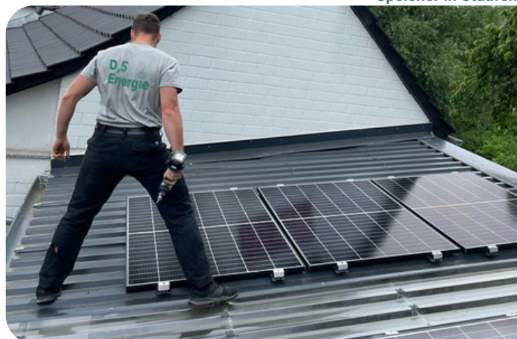
Referenz: 5 kWp Photovoltaikanlage mit 10 kWh Speicher in Staufen
