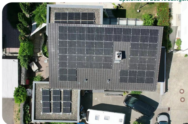
Referenz: 17 kWp Photovoltaikanlage mit 10 kWh Speicher in Bad Krozingen
